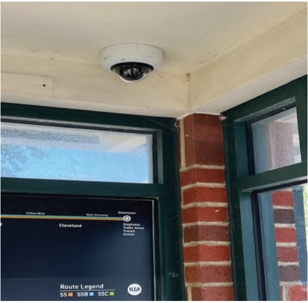
F Security Camera: Cámara De Seguridad
